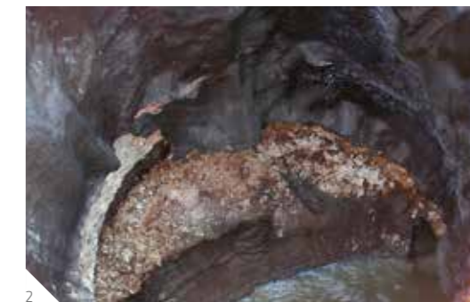
1 Esimerkki HDPE-kalvon vaurioista H 2 S -mikrobien aiheuttamissa korrosio-olosuhteissa. 2 Esimerkki HDPE tai vastaavasta kalvosta, joka ei ole suojannut muuttia H 2 S -korrosiolta.
