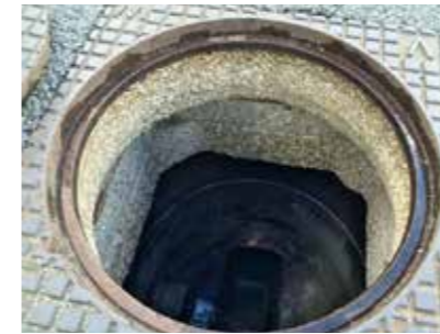
Sisäänkäynti biogeeniselle korroosiolle altistuneeseen viemäriin vain 3 vuoden käytön jälkeen.
