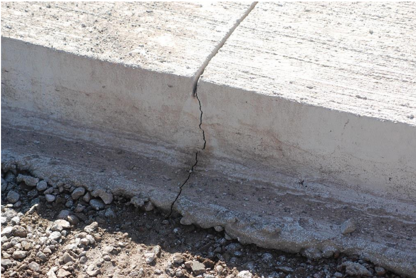
Kuva halkeamasaumasta; haljennut betonilaatta
