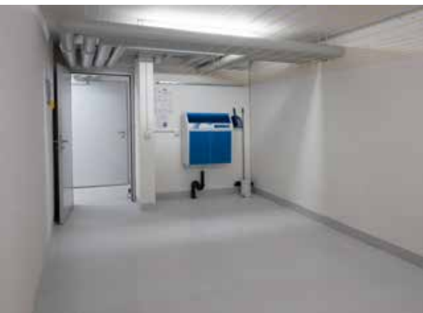
Asuinrakennusten tekniset tilat
