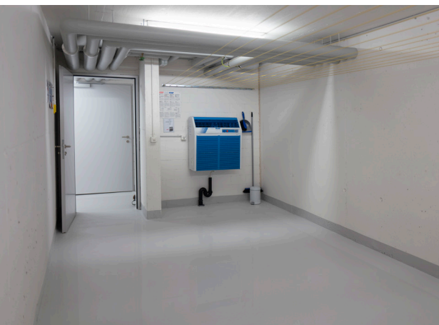
Asuinrakennusten tekniset tilat
